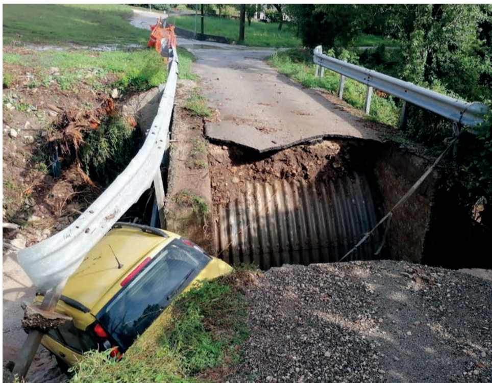
Morcone, 16 settembre: i danni causati del maltempo.
